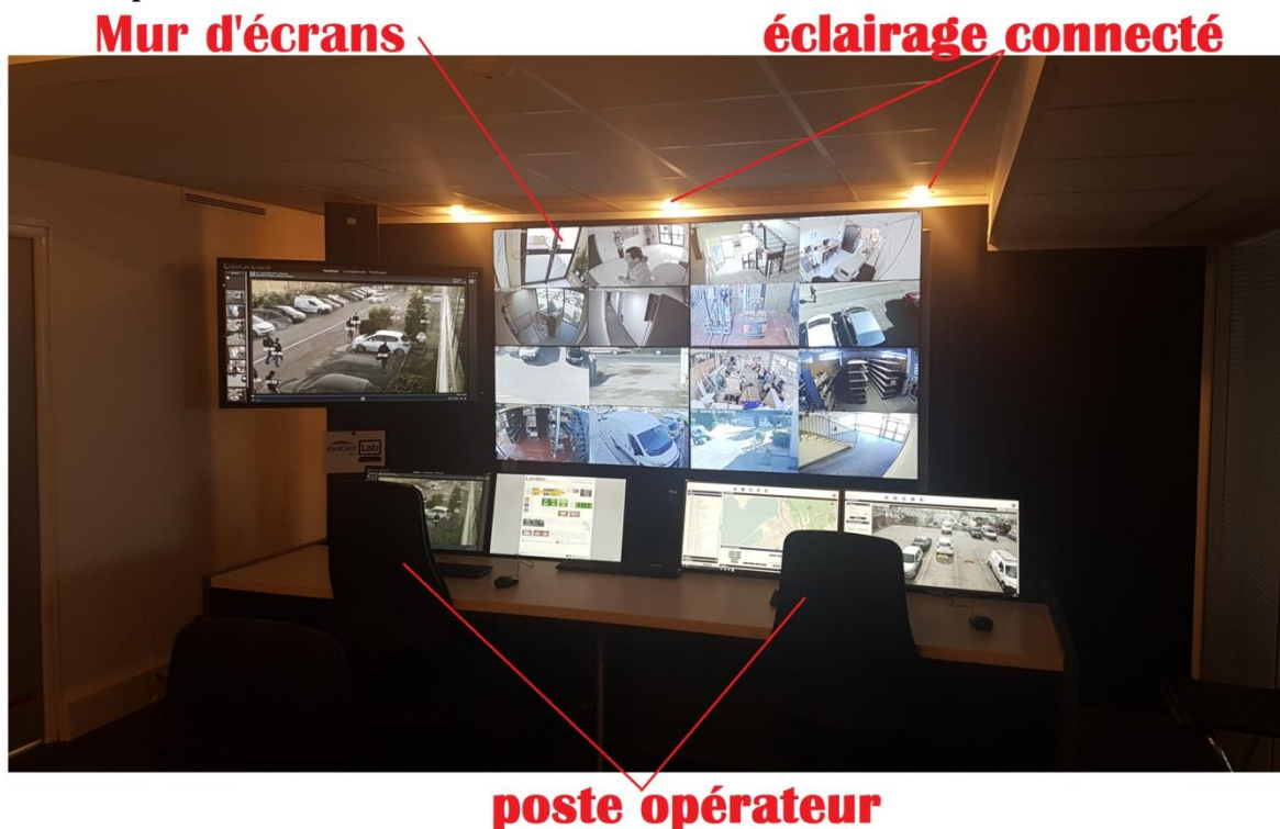
Figure 5: Poste opérateur du LAB
